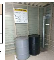
積替え保管場所 (廃油)
