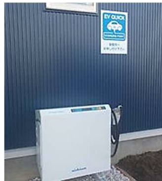
管理棟の急速充電器
