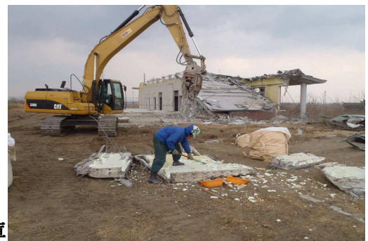
【写真】津波を受けた仙台市馬術場倉庫
